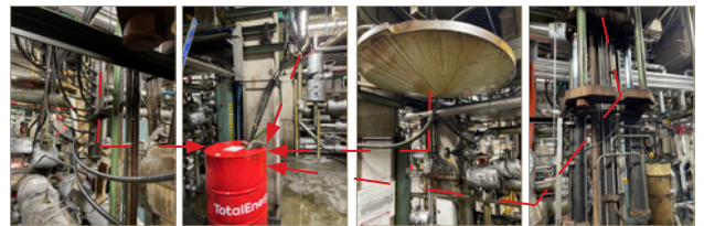
40 Ölauffangfässer à 200 Liter befinden sich im Untergeschoss (1 Fass pro Presse, 2 Fässer am Ende jeder Presslinie, 1 Mobiles).
