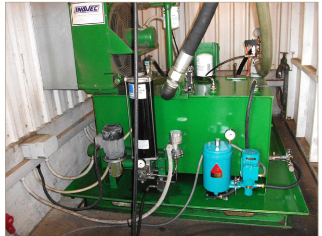
CJC® Ölpflegesystem 15/25 installiert an dem Hydraulikaggregat der Blockbandsäge
