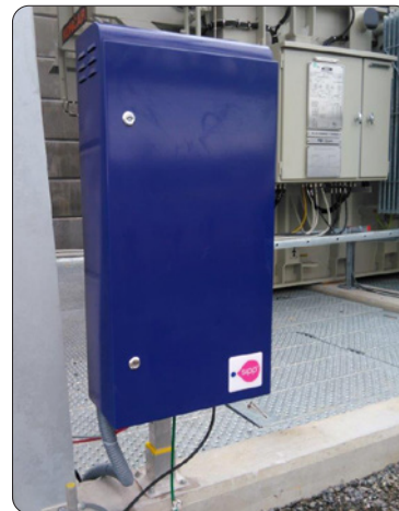
SIPP™ Node 500 installiert an der Trafowanne
